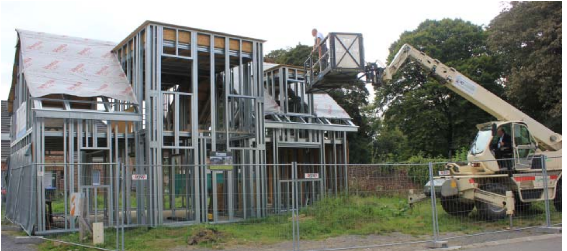
En construction près de l'église de Provin, la maison ne passe pas inaperçue.
